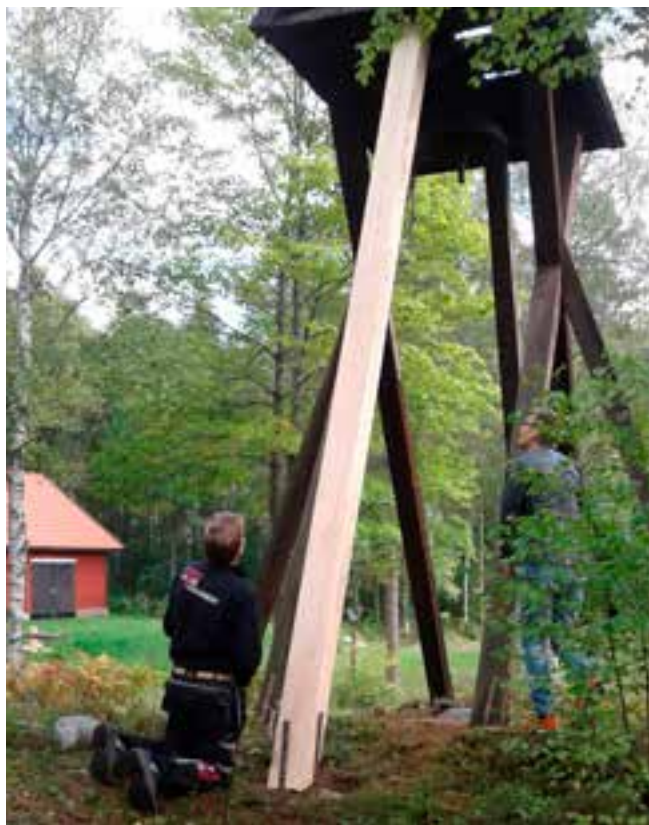
Ett av stödbenen på klockstapeln visade sig vara murket och nu byttes det mot ett nytt och bättre i samband med arbetsdagen på Hembygdsgården den 16 september.
